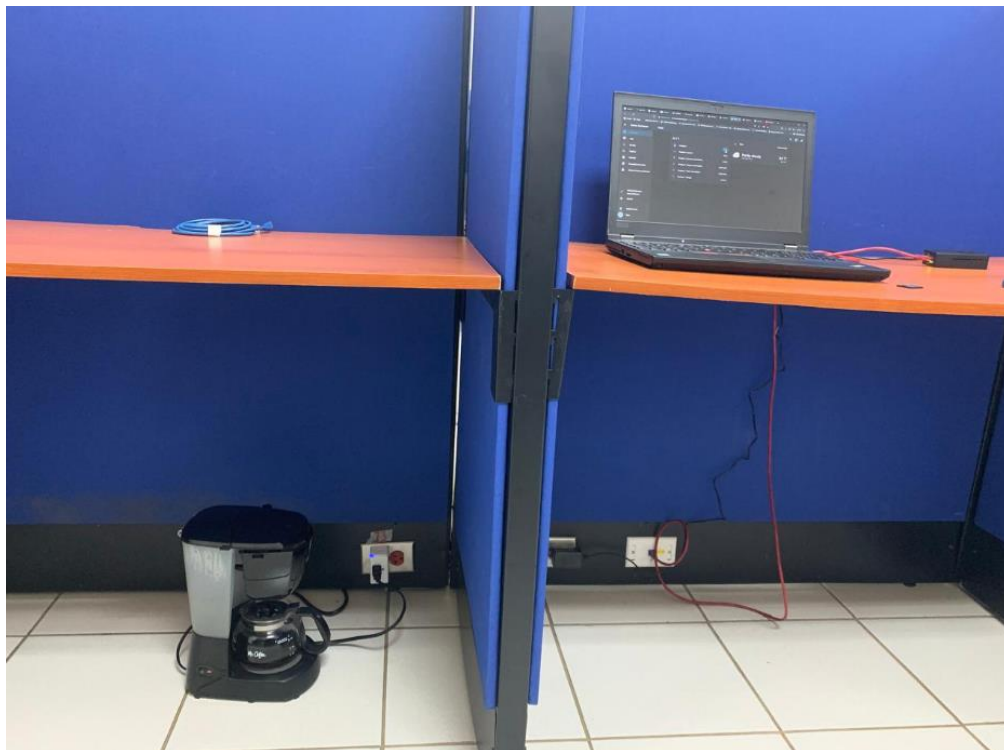
Figura No. 35 Monitoreo de consumo energético en sala de profesores de telecomunicaciones
