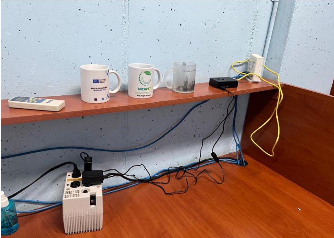
Figura No. 28 Conector TP-Link K115 conectados a UPS parte 2
