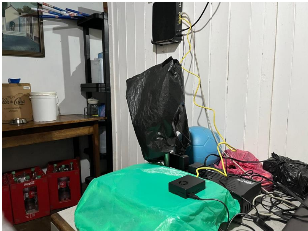
Figura No. 40 Equipo instalado en pulpería "Chico"
