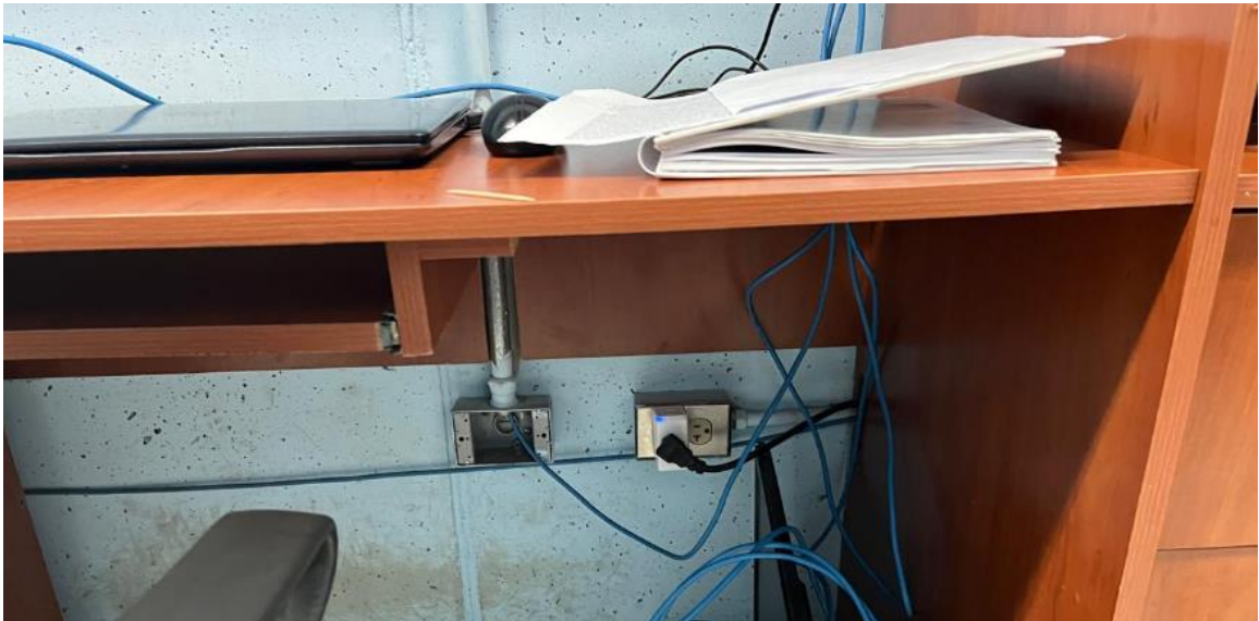
Figura No. 27 Conector TP-Link K115 conectado a UPS parte 1
