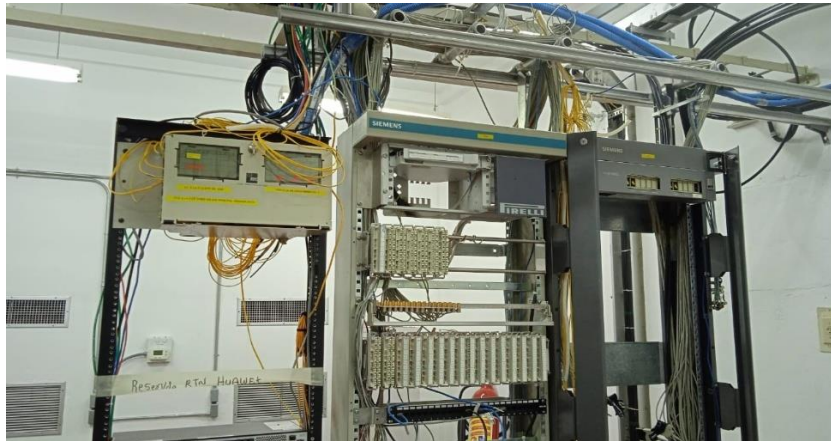
Figura No 58. (Imagen propia). Sala de transmisiones sitio Mombacho
