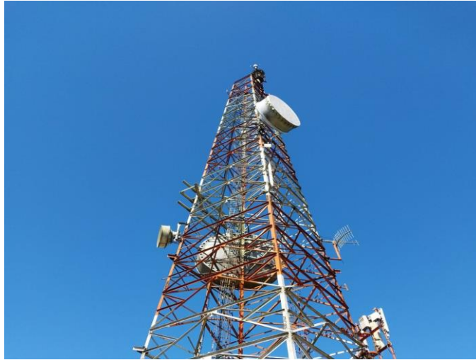
Figura No 56. (Imagen propia). Torre sitio Mombacho
