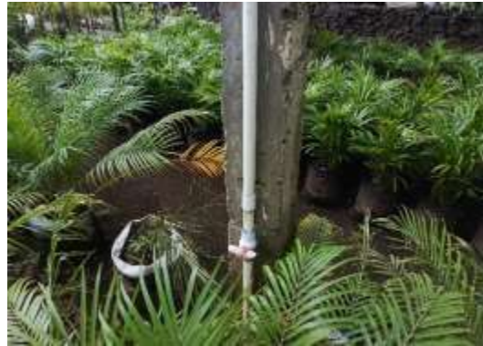
Ilustración 12. Sistema de tuberías
