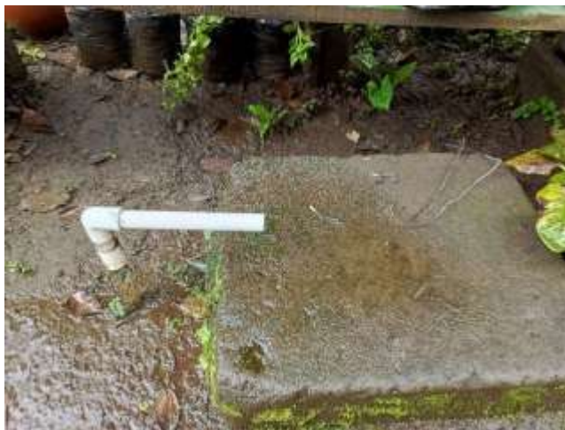
Ilustración 3. Tubo de entrada a la bomba
