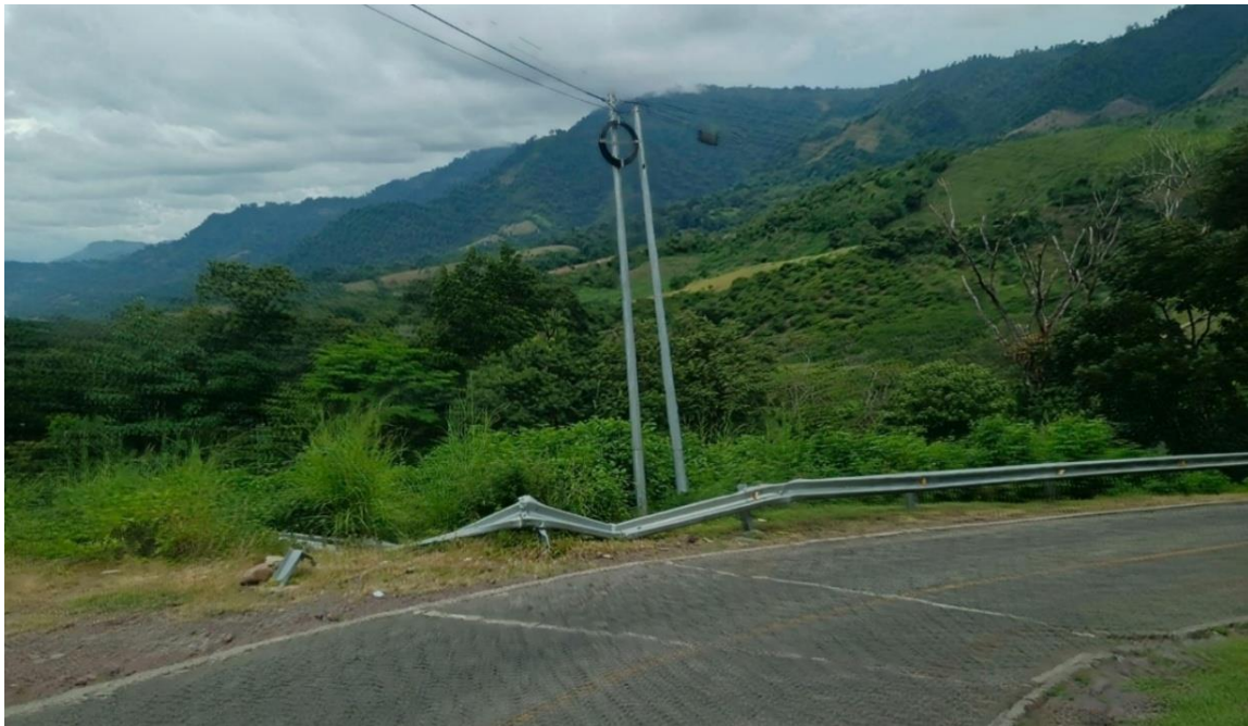
Ilustración 25. Puntos críticos sin señalización vial.
