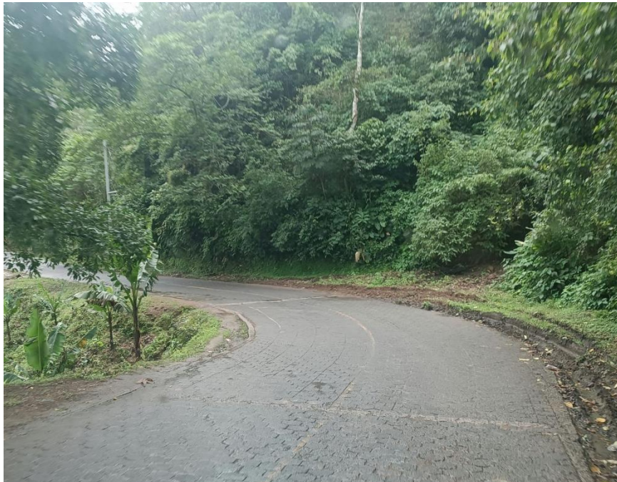
Ilustración 31. Puntos críticos sin señalización vial.
