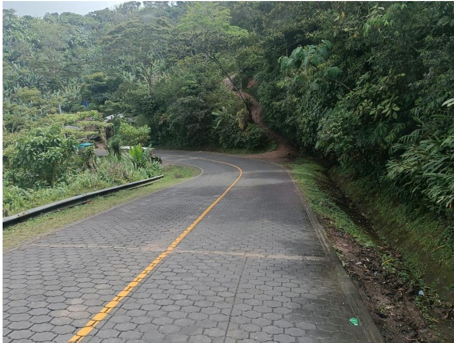
Ilustración 32. Puntos críticos sin señalización vial.
