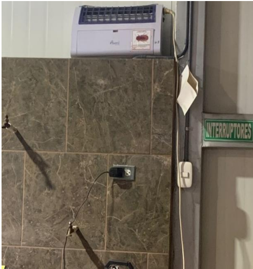
Figura 54. Contactos eléctricos Directos/Indirectos
