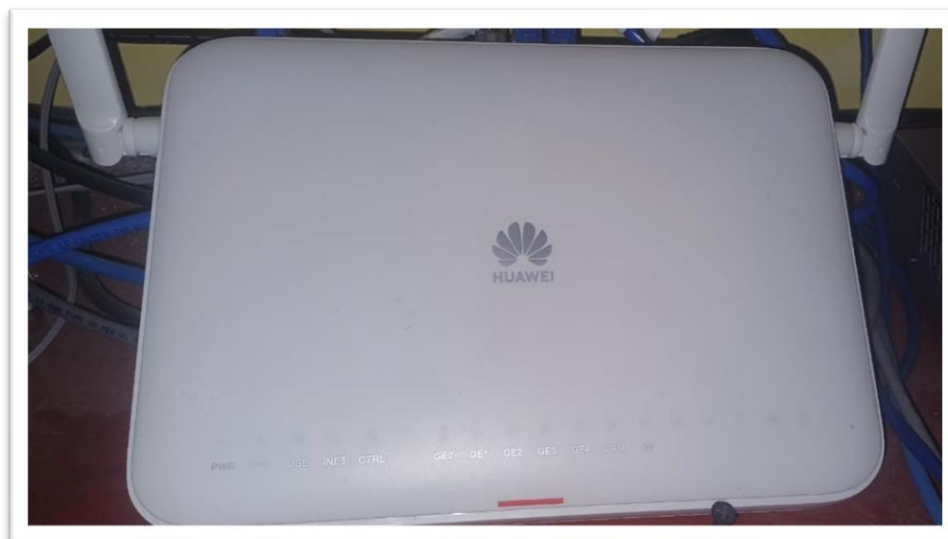
Dispositivo Router Huawei AR600 instalado en la Sucursal San Juan
