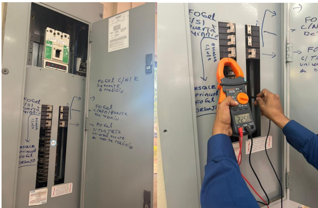
Figura A.5 Centro de carga del sistema de climatización de la sala de lectura.
