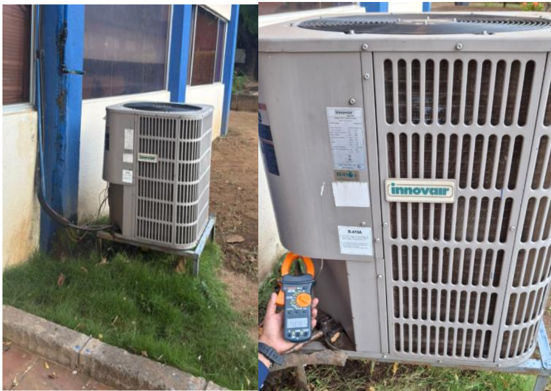
Figura A.6: Compresor de la unidad de A.A. del área de recepción.
