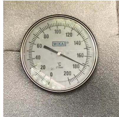
Figura No. 4.5. Termómetro fijo en tanques.
