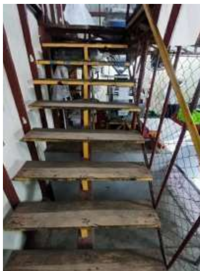
Figura 13. Escalones antes de la entrega, en mal estado
