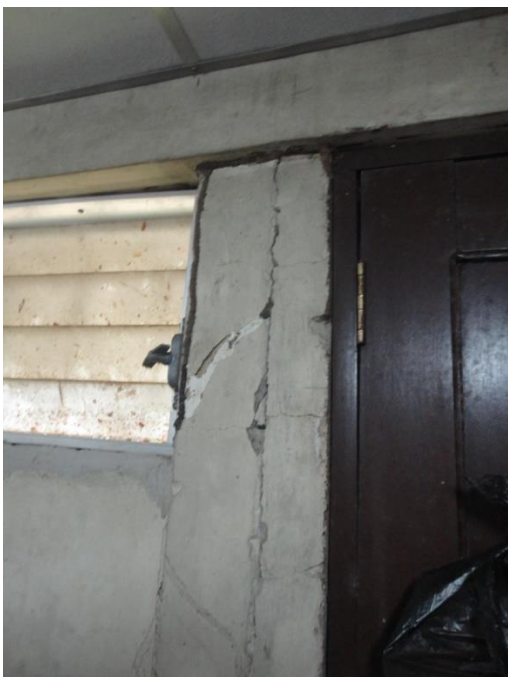
Foto N° 6 Falla en la infraestructura
