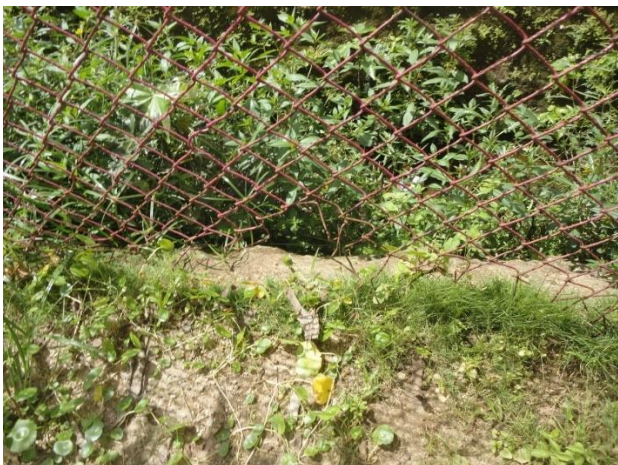
Foto N° 5 Vista del deterioro del cerco perimetral
