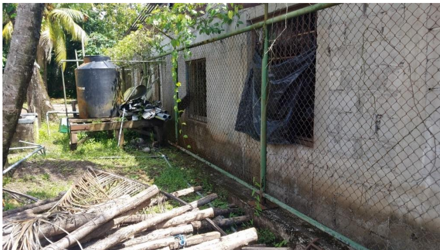
Foto N° 3 Vista del deterioro en las paredes y cerco perimetral
