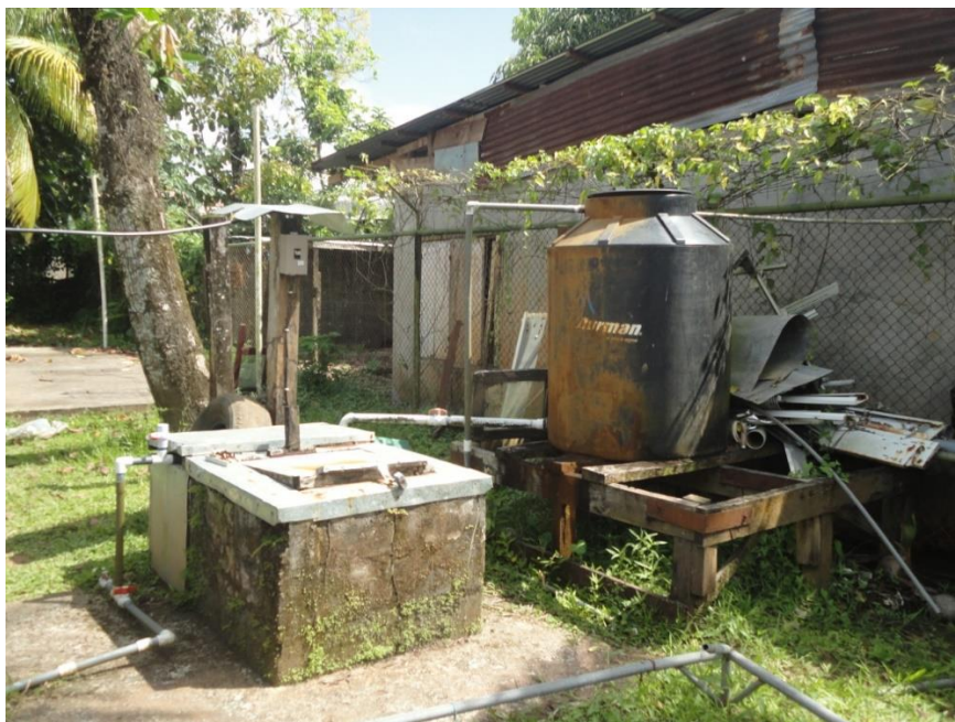
Foto N° 4 Vista del deterioro del sistema de abastecimiento de agua
