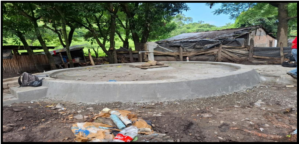
Figura 31. Bomba y pozo existente
