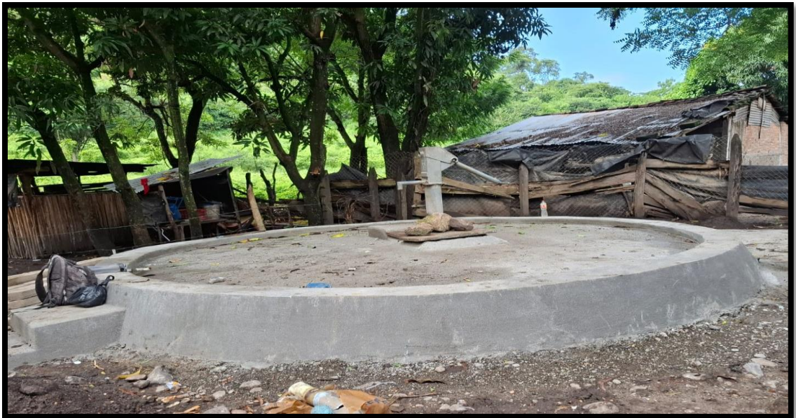
Figura 3: Pozo y bomba manual existente.
