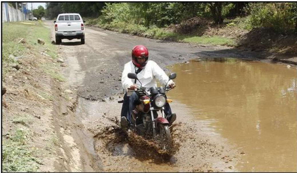
Figura 27. Acumulación de agua en el tramo. Est 0+900
