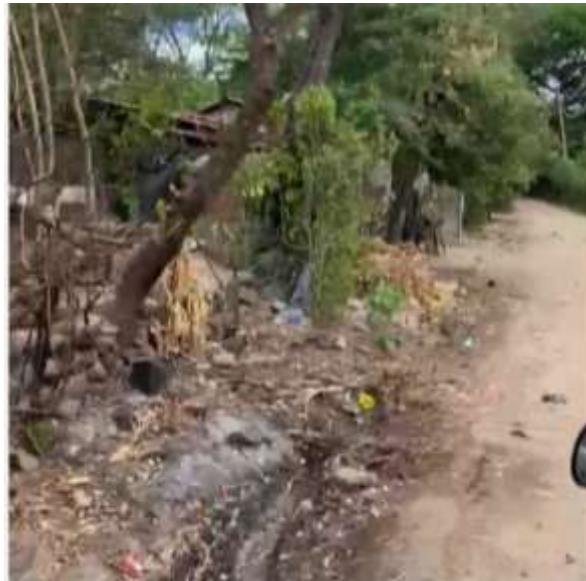
Figura 26 Ausencia de estructuras de drenaje en la EST 0+500
