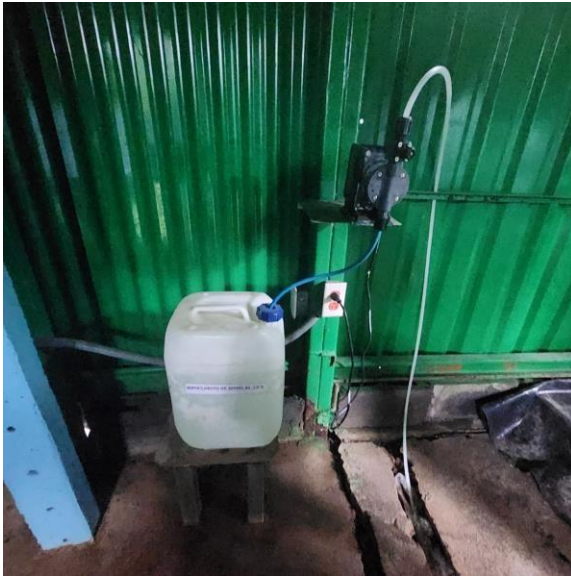
Figura 12. Sistema de clorinación a la salida del pozo.
