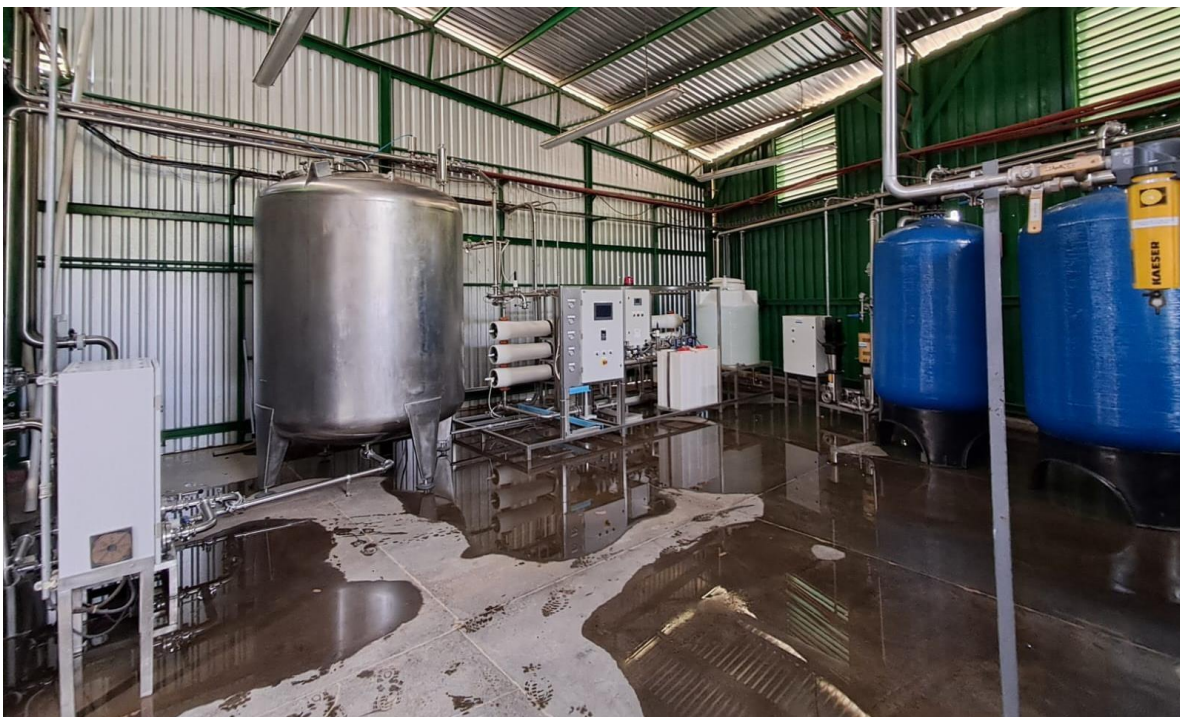
Figura 16. Sistema de tratamiento de agua mediante nanofiltración
