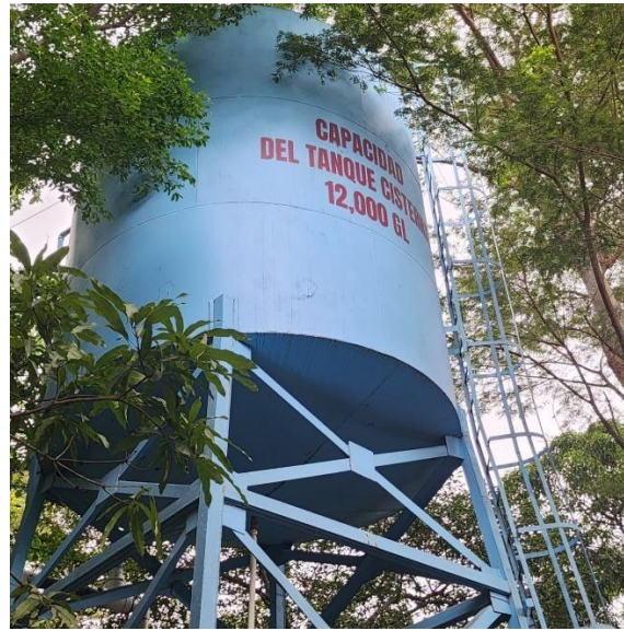
Figura 13. Tanque cisterna de almacenamiento de agua potable
