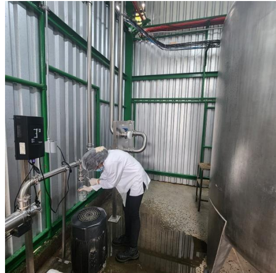
Figura 21. Toma de muestra en PM3 (Salida del sistema de Nanofiltración).
