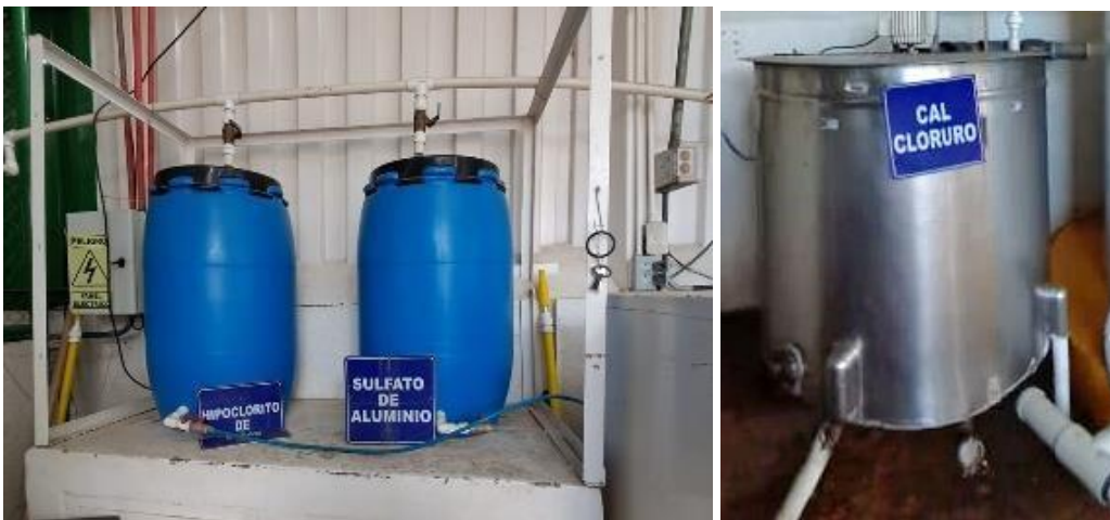
Figura 14. Sistema de dosificación de desinfectante, coagulante y floculante
