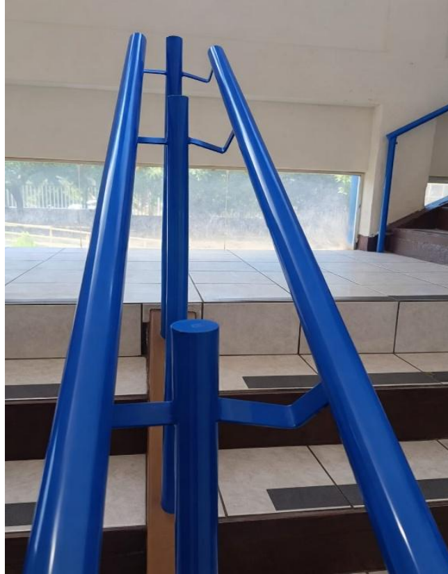
Figura 41 Muestra de patología (oxidación y corrosión) intervenida en pasamanos de escalera subiendo al segundo piso de la biblioteca Esman Marín. Fuente: Elaboración propia.
