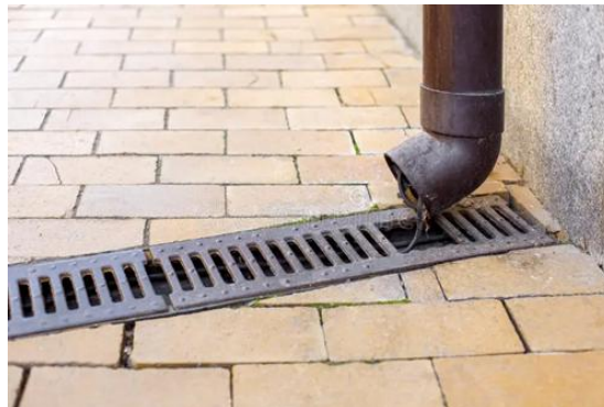
Figura 37 Rejilla de drenaje pluvial de acero inoxidable. Tomado de internet.
