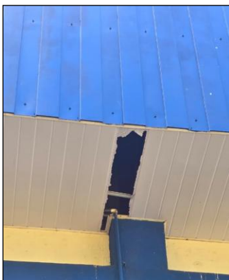
Figura 16 Lesión mecánica - Rotura de tablilla PVC en fascia Biblioteca Esman Marín. Fuente: Elaboración propia.
