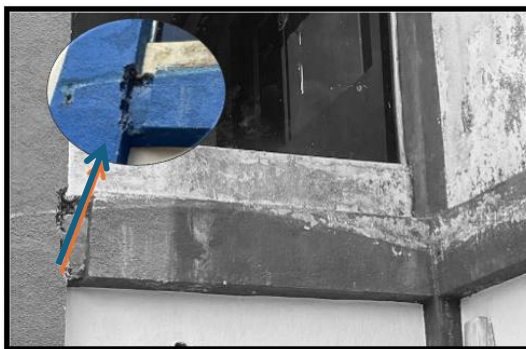
Figura 12 Lesión mecánica, grieta > 1mm por exposición en Biblioteca Esman Marín. Fuente: Elaboración propia.
