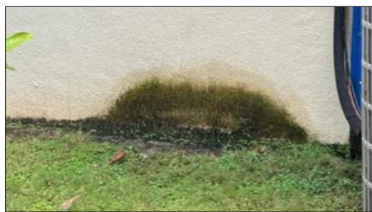
Figura 14 Lesión física - humedad en pared en Biblioteca Esman Marín. Fuente: Elaboración propia.
