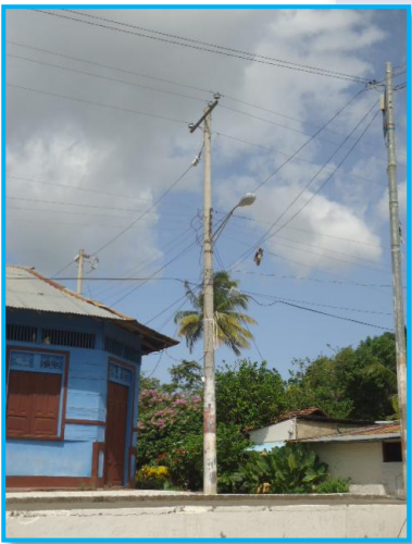
Ilustración 34 Poste de tendido eléctrico, fuente: Equipo M-IO 2014
