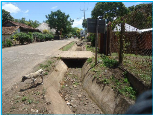
Ilustración 33 Canaleta para el drenaje pluvial, Fuente: Equipo M-IO 2014
