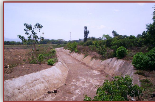
Foto No.16: Vista lado oeste barrio El Chorizo. FI: Levantamiento de campo. 2009
