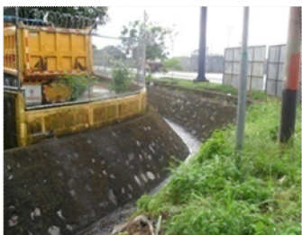
Foto 15 Sistema de agua pluvial a través cauces revestidos Fuente: ENACAL Ing. Luigi José Navas tercero
