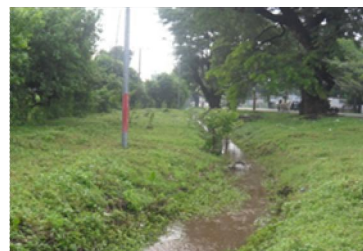
Foto 17 Sistema de agua pluvial a través cauces revestidos Fuente: ENACAL Ing. Luigi José Navas tercero
