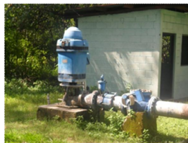
Foto 12 pozo para extracción de agua potable Fuente: ENACAL Ing. Luigi José Navas tercero
