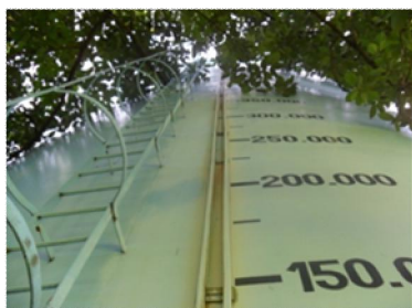
Foto 11 Sistema de almacenamiento de agua potable capacidad de 500000 galones Fuente: ENACAL Ing. Luigi José Navas tercero
