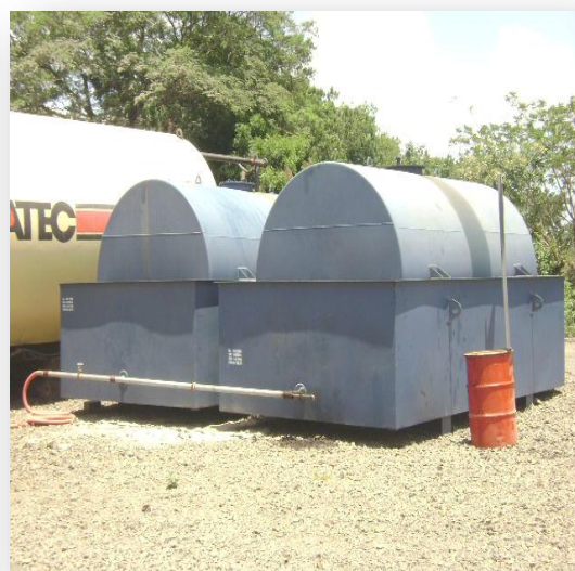
Foto No.20 Tanques de almacenamiento de combustible
