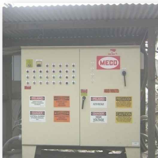
Foto No.12 Control de mando
