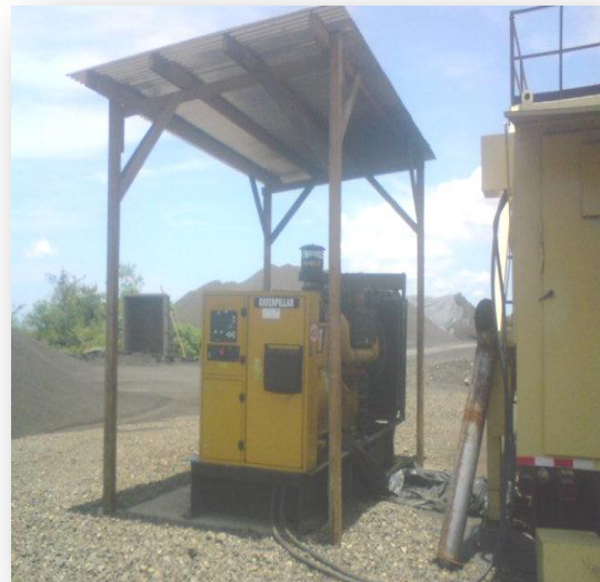
Foto No.24 Planta eléctrica
