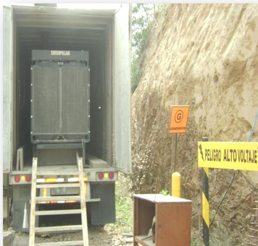
Foto No.13 Generador Caterpillar
