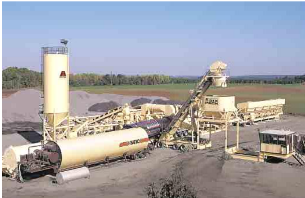
Figura No.18 Vista de la planta de asfalto.
