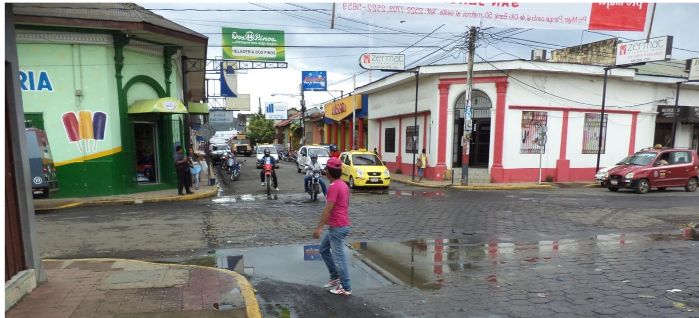
ILUSTRACIÓN 91. PROBLEMA DE ESTANCAMIENTO DE AGUA PLUVIAL EN INTERSECCIONES. FUENTE: EQUIPO DE TRABAJO.
