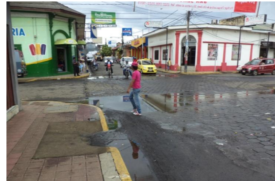
ILUSTRACIÓN 116. RAMPA MAL UBICADA Y SEÑALIZADA, TAMBIÉN ES UN ELEMENTO QUE GENERA ESTANCAMIENTO DEL AGUA. FUENTE: EQUIPO DE TRABAJO.
