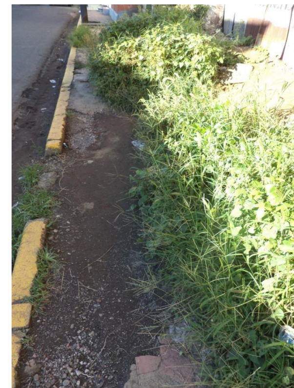
ILUSTRACIÓN 90. PROBLEMA EN ANDENES ABANDONADOS, PRESENCIA DE ORGANISMOS VEGETALES. FUENTE: EQUIPO DE TRABAJO.
