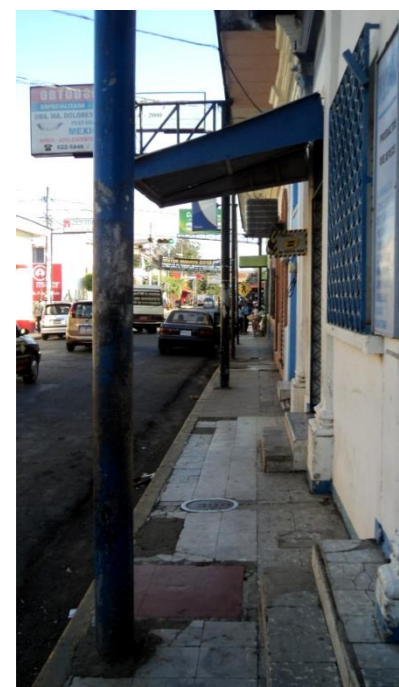
ILUSTRACIÓN 69. PROBLEMÁTICA EN ANDENES. FUENTE: EQUIPO DE TRABAJO.
