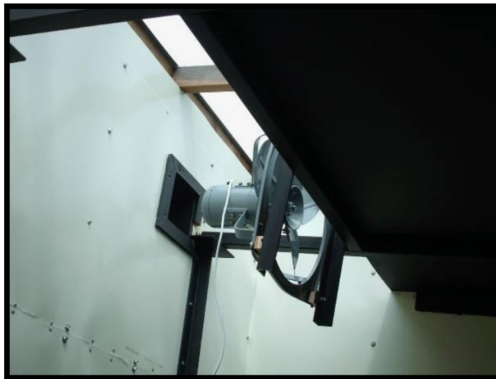
Figura 6.3: Ubicación e instalación e instalación del ventilador, Cartago
