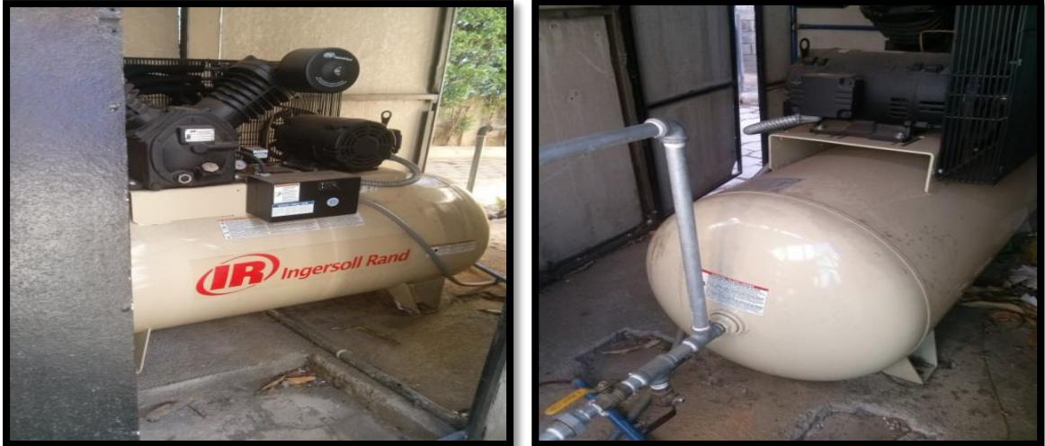
Imagen 8 y 9. Compresor abierto de tipo pistón marca Inngersoll Rand.Fuente Elaboración propia.
