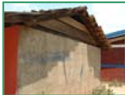
Vista lateral del agrupamiento de techos se observa la estructura del techo en mal estado.
