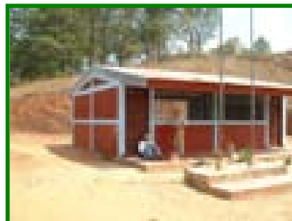
Vista externa de aula, se observa la falta de protección en las ventanas.
