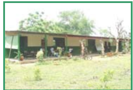
Vista de las aulas, donde se puede apreciar el requerimiento de un aula, debido al uso del pasillo como aula de clase.
