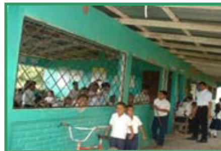
Vistas interior de un aula donde se aprecia solo el vano de las ventanas sin persianas y falta de mantenimiento del agrupamiento.
