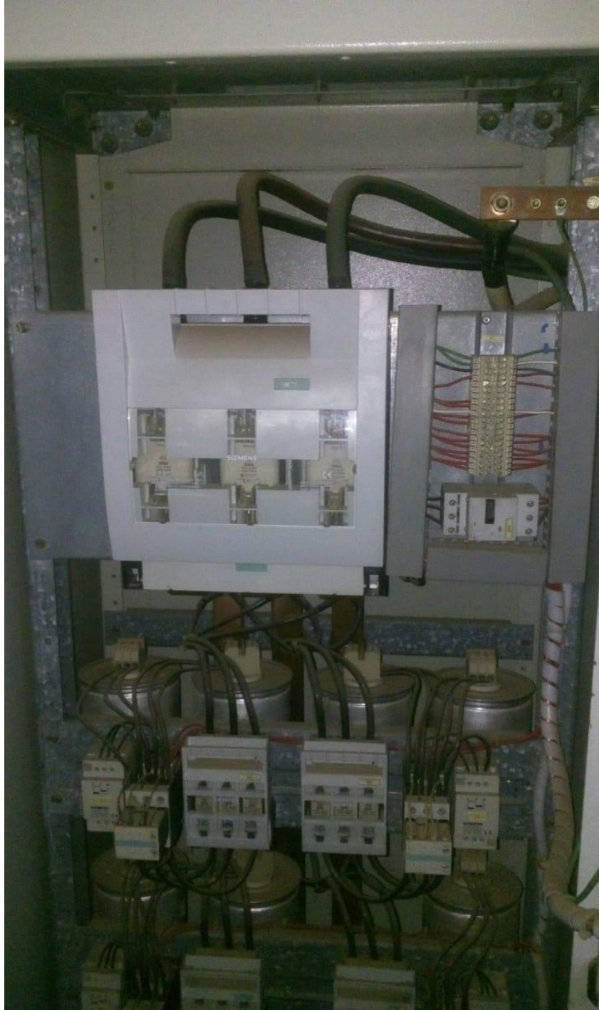
Main principal de entrada y dos interruptores de salida.
