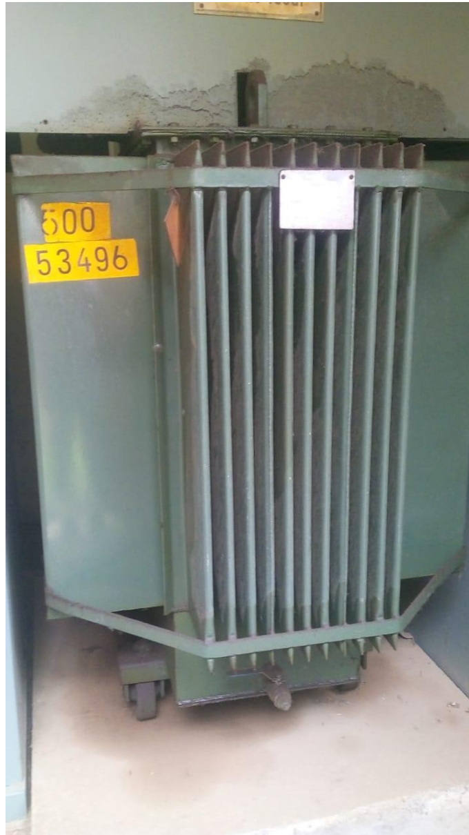
Transformador de 500 KVA, conexión estrella delta
