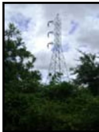
Subestación del servicio eléctrico (Tecolostote)
