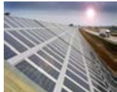
Paneles solares Fotovoltaicos
