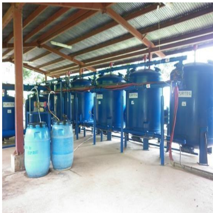
PTAP Presurizada de 45 lps
