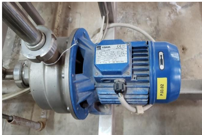
Ilustración 9. Bomba de agua caliente
