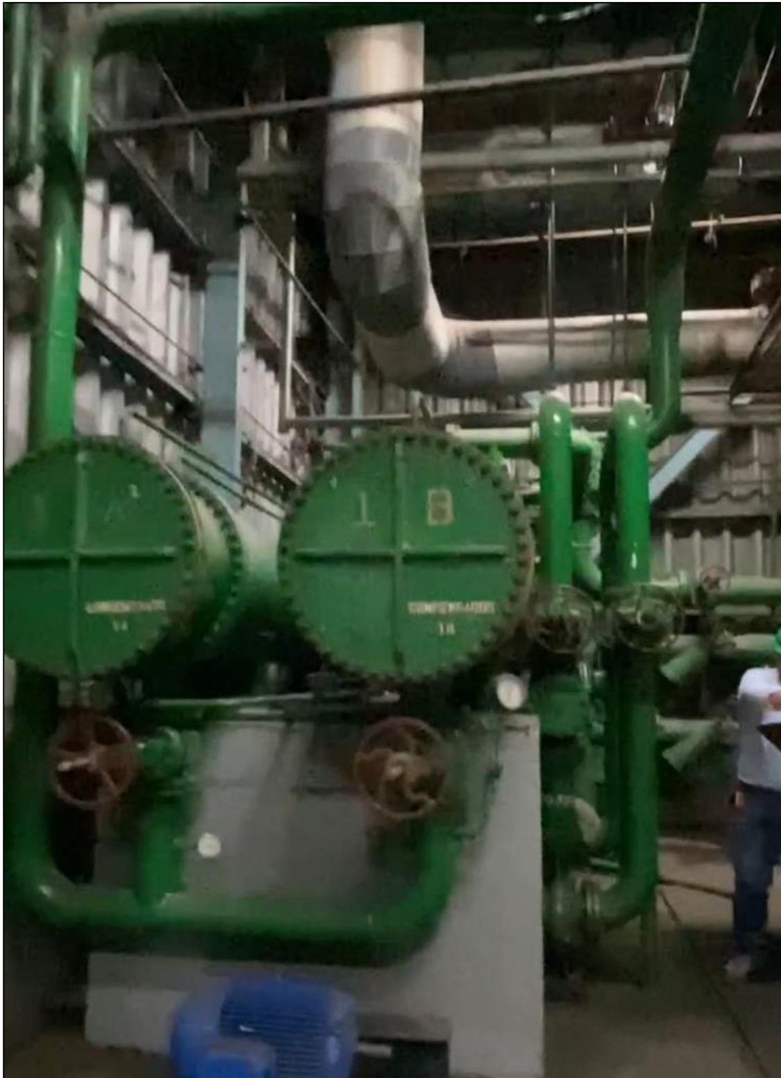
Figura 9: Condensador. Fuente: Ingenio San Antonio
