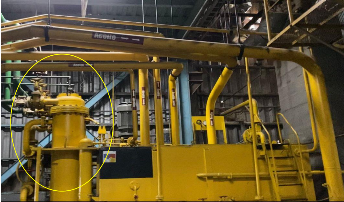
Figura 10: Intercambiador de Aceite - TG1. Fuente: Ingenio San Antonio
