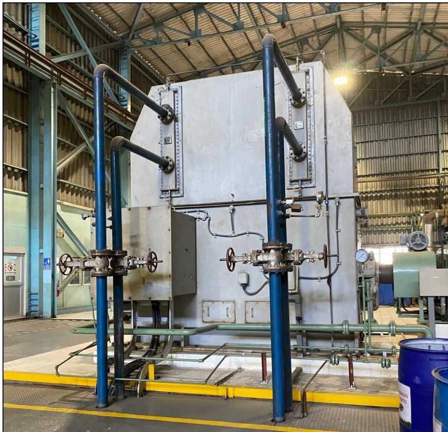
Figura 11: Intercambiador de Aire - TG2. Fuente: Ingenio San Antonio
