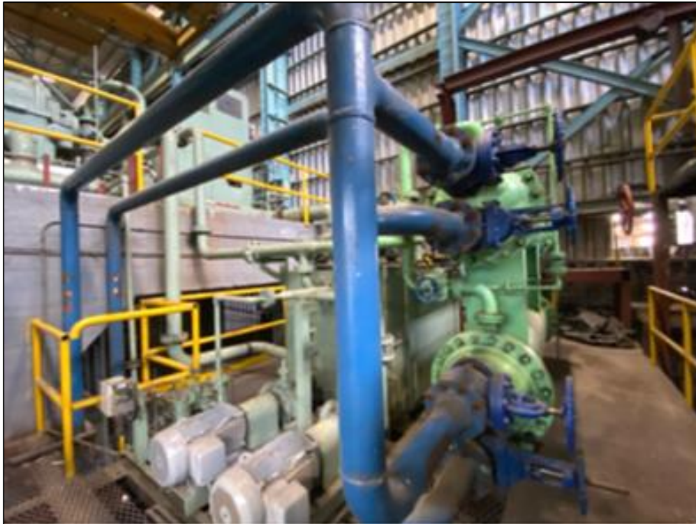
Figura 12: Intercambiador de Aceite - TG2. Fuente: Ingenio San Antonio.
